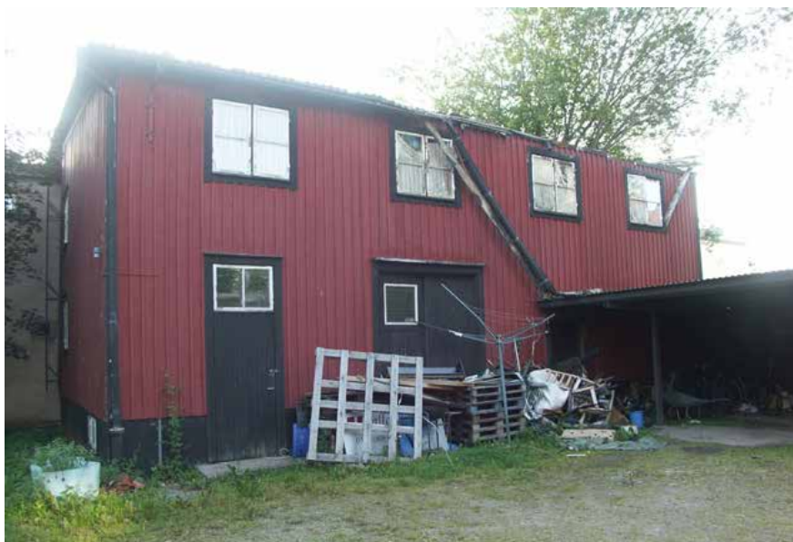
Bjursnäs, Laxå kommun: Nu riven uthuslänga i så dåligt skick att den innebar en fara för allmänheten.
